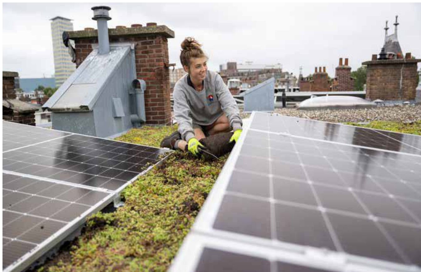
Een groen dak houdt de warmte buiten. Dit is goed te combineren met zonnepanelen.
