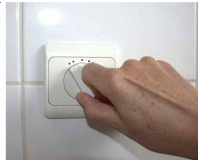
Laat de mechanische ventilatie aan staan.
